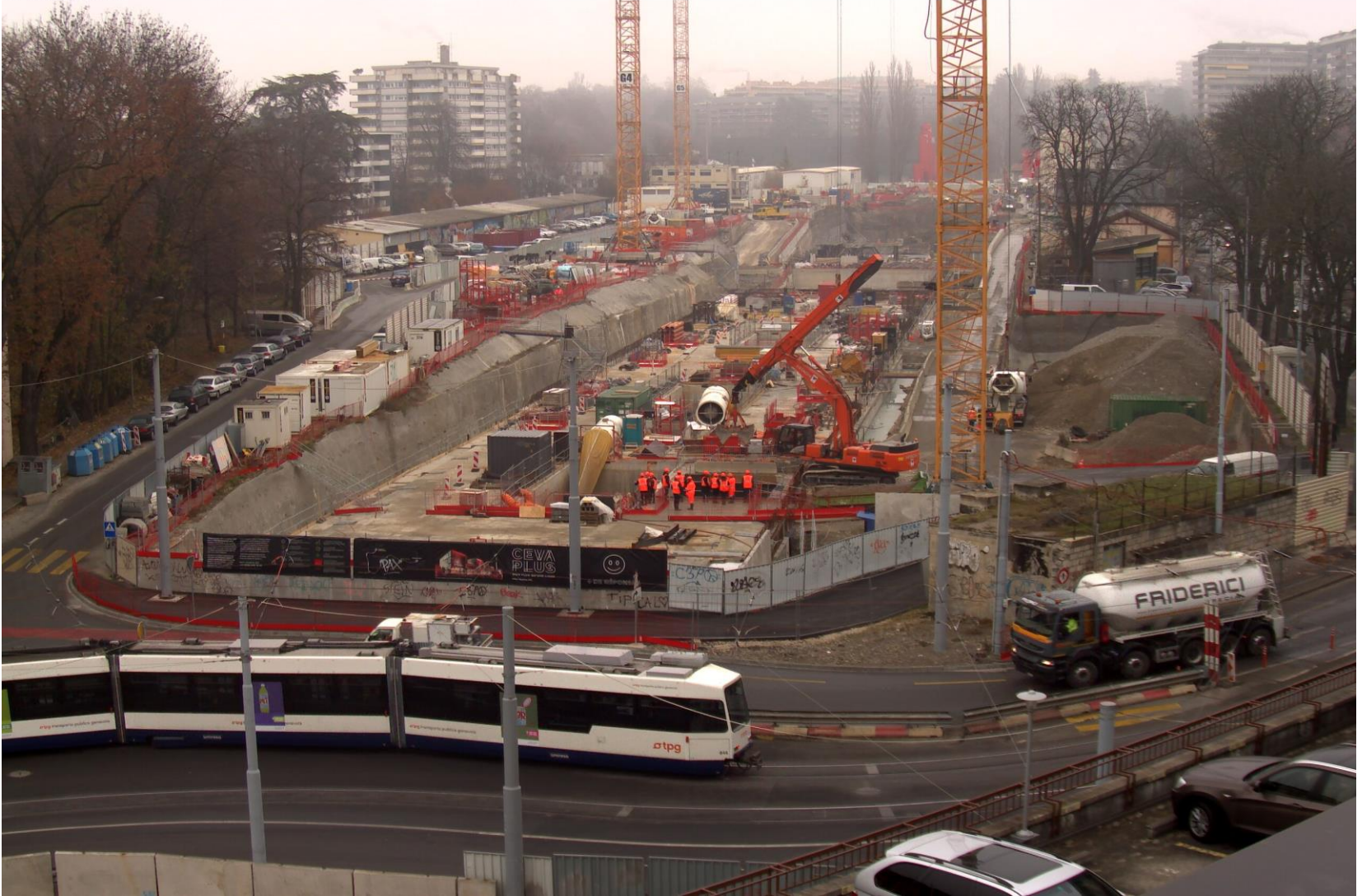
Le chantier de la gare du CEVA rue de la gare des Eaux-Vives (à droite, derrière l'alignement des platanes, le bâtiment des voyageurs de 1888 juste avant sa démolition
